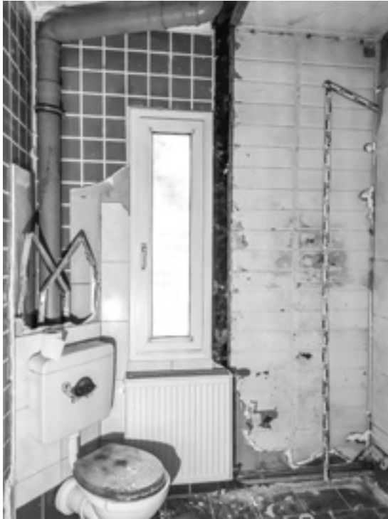
16. Eberswalde/Finow, Kupferhaus Typ K, Spuren einer beseitigten Innenwand. Links der ehemaligen Wand die Kachelmusterung des Bades, rechts die oblonge Prägung der Wohnküche, Foto 2020
