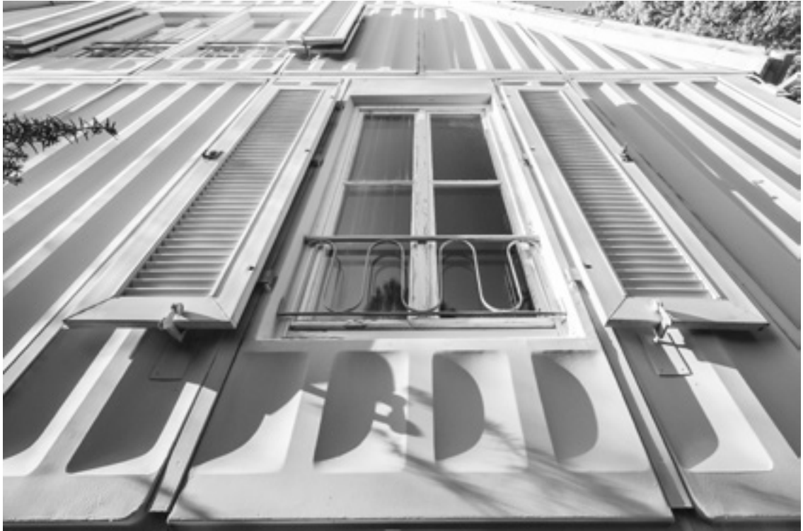
20. Stuttgart-Sillenbuch, M.A.N.-Stahlhaus, Ostfassade mit plastischen Verformungen der Tafelfugen aufgrund thermischer Spannungen
