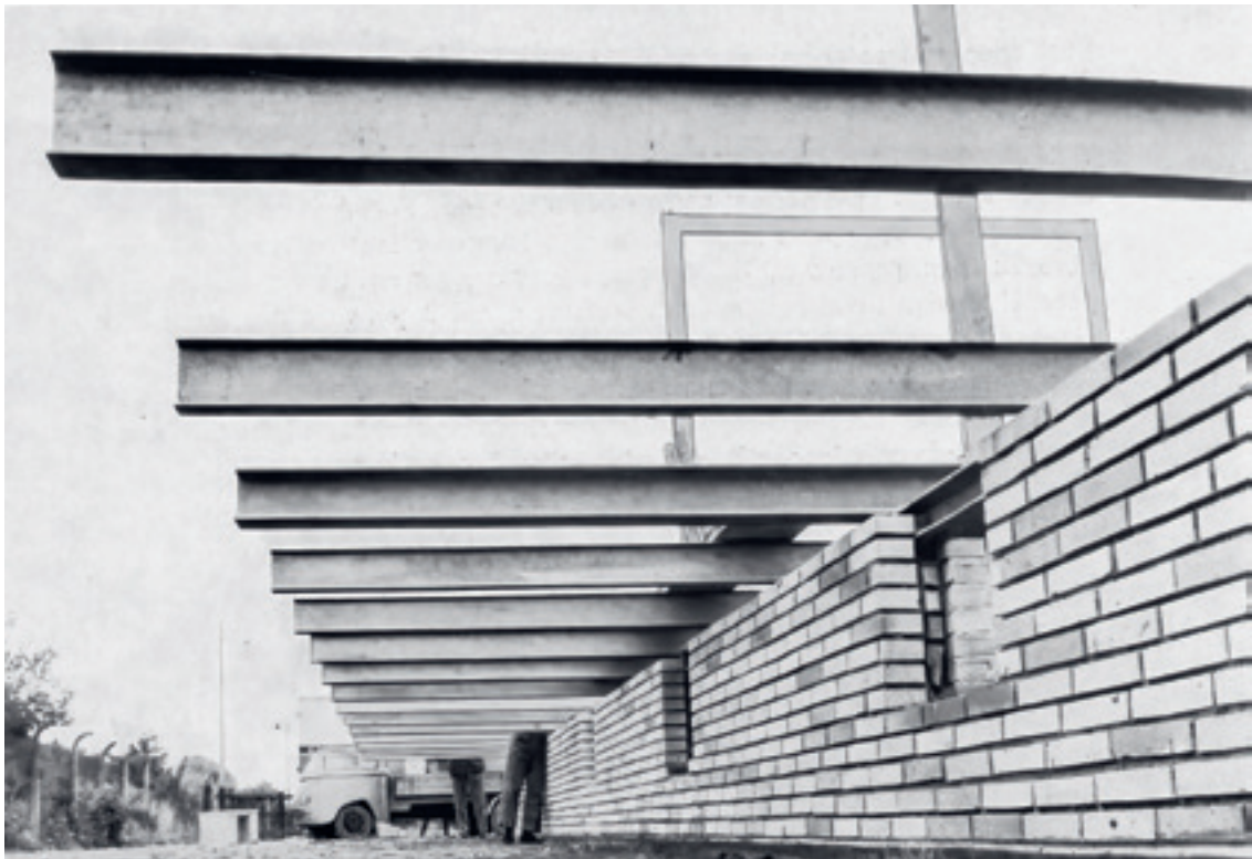
17. Quelle-Fertighaus, kragende Deckenträger über der Auflagerschwelle auf den Kellerwänden, die zugleich Sturz für die Kellerfenster sind
