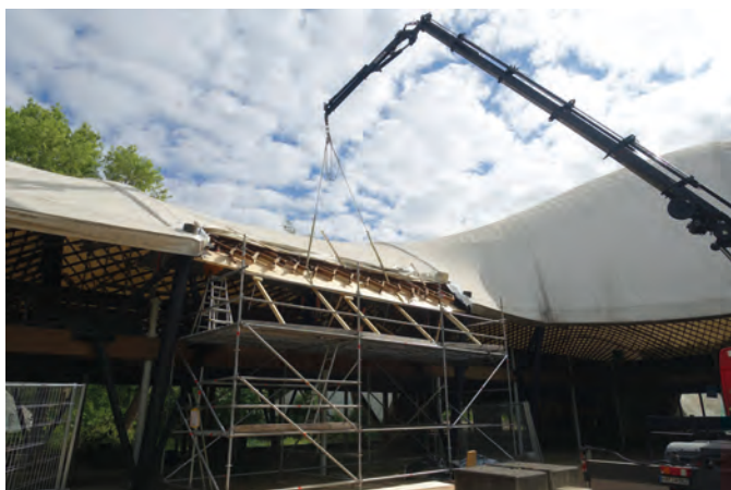
Bild 12 Der Austausch eines Randträgers ließ Rückschlüsse auf den Zustand der anderen Träger zu (Quelle: Fast + Epp) Replacement of an edge beam allowed conclusions about the condition of the other beams
