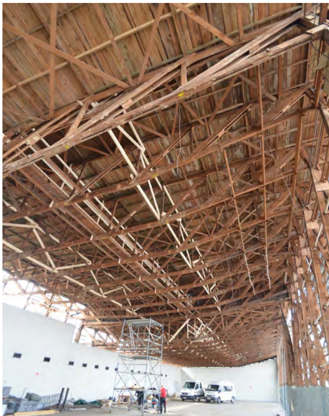
Bild 7 Erfurt, Fischbauträger der ega-Ausstellungshallen, Bj. 1959, Foto 2011 (Quelle: Mark Escherich, Erfurt) Erfurt, fish-bellied beam at ega-exhibition hall, constr. year 1959, photo 2011
