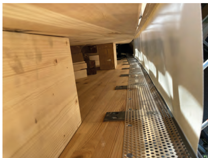
Bild 13 Schubverbinder verstärken die Randträger und ein neues Membrandetail zur Hinterlüftung wurde getestet (Quelle: Fast + Epp) Shear connectors reinforce the edge beams and a new membrane detail for rear ventilation was tested
