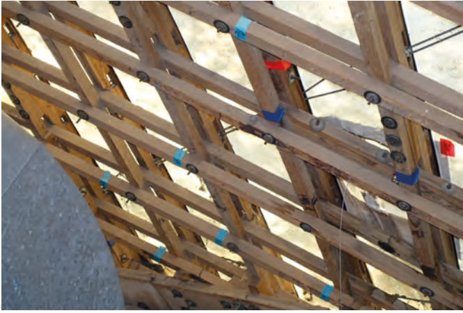
Bild 6 Die Schäden wurden durch das Holzbauunternehmen mit Klebeband markiert und einem Schadenstyp zugeordnet (Quelle: Fast + Epp) The timber construction company marked the damage with adhesive tape and assigned a damage type
