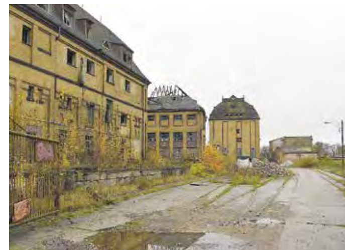
Nach mehr als drei Jahrzehnten Verfall und mehreren Brandstiftungen soll die Sternburg Brauerei in Leipzig-Lützscha ein Wohngebiet werden. Foto: Edgar Bergstein, 2023
